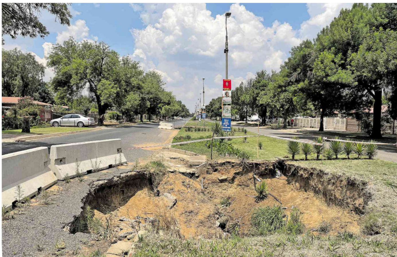
Erzürnt die Anwohner: Tiefe Löcher in einer Straße in Vanderbijlpark, einem Teil der Gemeinde Emfuleni
